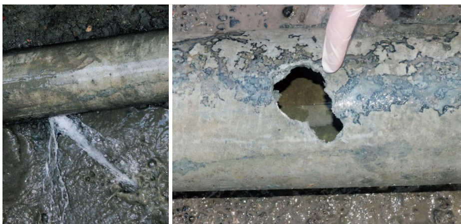
Figura 2 - Tubazione idrica in cemento amianto lesionata.
